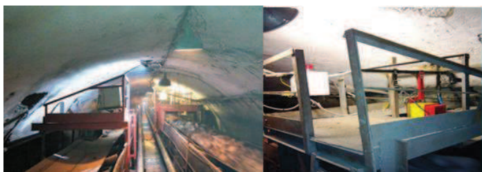
Рис. 2. РКС РЛП–21Т на конвейере № 1А и РКС РЛП–3–02 на конвейере № 1
